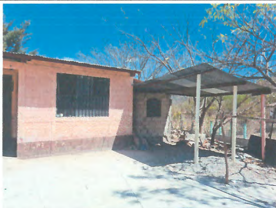
Foto 3: Daños en el área de cocina
