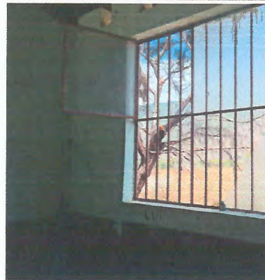
Foto 6: Daños en la pintura exterior e interior
