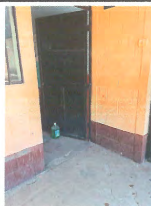
Foto 8: Daños en piso, pintura y puertas
