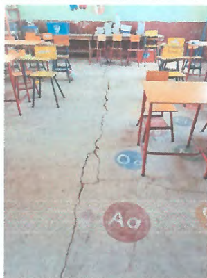
Foto 1: Daños en los pisos de las aulas
