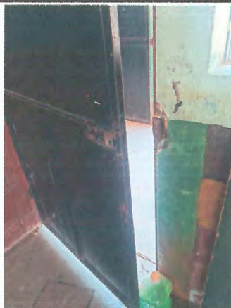
Foto 7: Daños en pintura de muro interior
