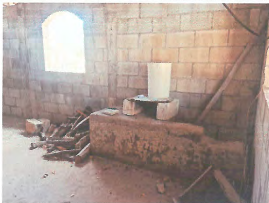
Foto 5: Daños en área de cocina
