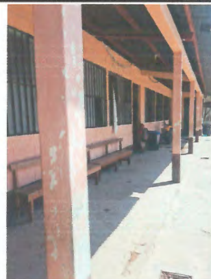
Foto 2: Daños en la pintura exterior e interior
